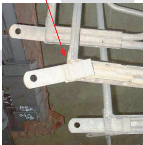
※供試体 No.1 [前踏み側中央部] 取付プレートのはずれ
